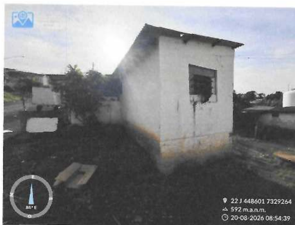
Fotografia 2 – vista lateral/posterior — esquadria danificada e mancha de umidade ascendente na base da alvenaria.
