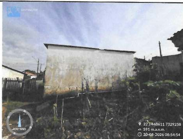
Fotografia 3 – parede de fundos — reboco deteriorado, umidade ascendente generalizada e vegetação encostada à edificação.
