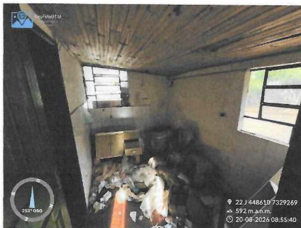
Fotografia 4 – interior, cômodo (cozinha) com armário remanescente, acúmulo de resíduos sólidos e entulho no piso.
