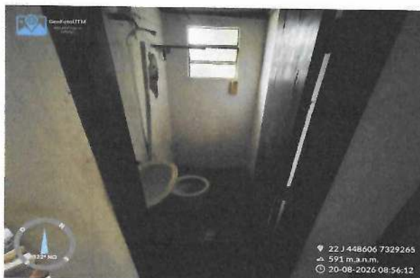
Fotografia 8 – instalação sanitária — louças (vaso e lavatório) sem caixa de descarga aparente, paredes com infiltração e fiação exposta.
