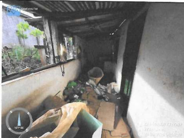
Fotografia 5 – área de circulação coberta (varanda/corredor) tomada por lixo, entulho e materiais descartados.
